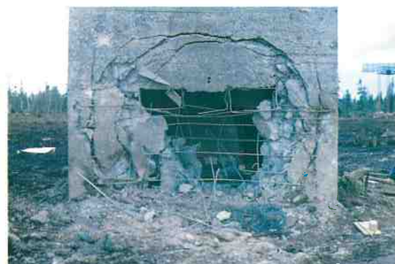
Smällarna gjordes för att mäta höga tryck. En bunker som byggts nära nollpunkten såg ut så här efteråt.
